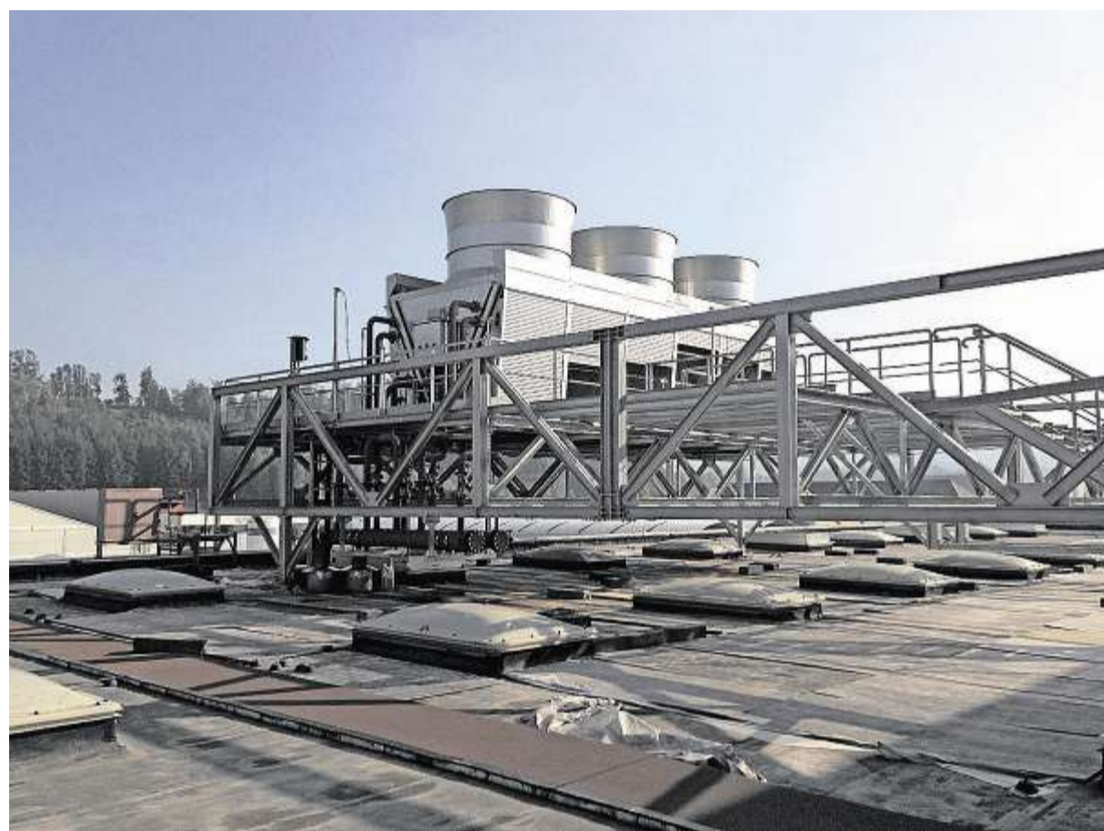
Die Dächer von Industrieanlagen sind ideal für die Gewinnung von Sonnenstrom. Foto: Ingenieurbüro Brundobler
