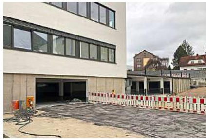
Die Stellplätze im Untergeschoss und auf dem Parkplatz werden in „öffentlich“ und „privat“ aufgeteilt.
